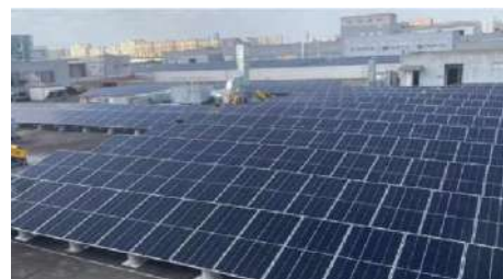
中國據點太陽能發電站一隅
